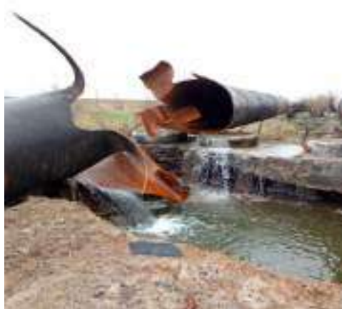
Рис. 5.18. Пошкоджений водогін «Дніпро-Миколаїв» на території Херсонської області, 2022 рік
